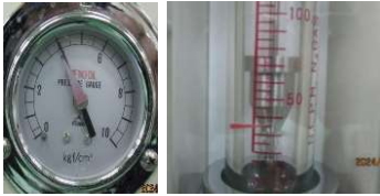
窒素ガス圧力計と流量計
